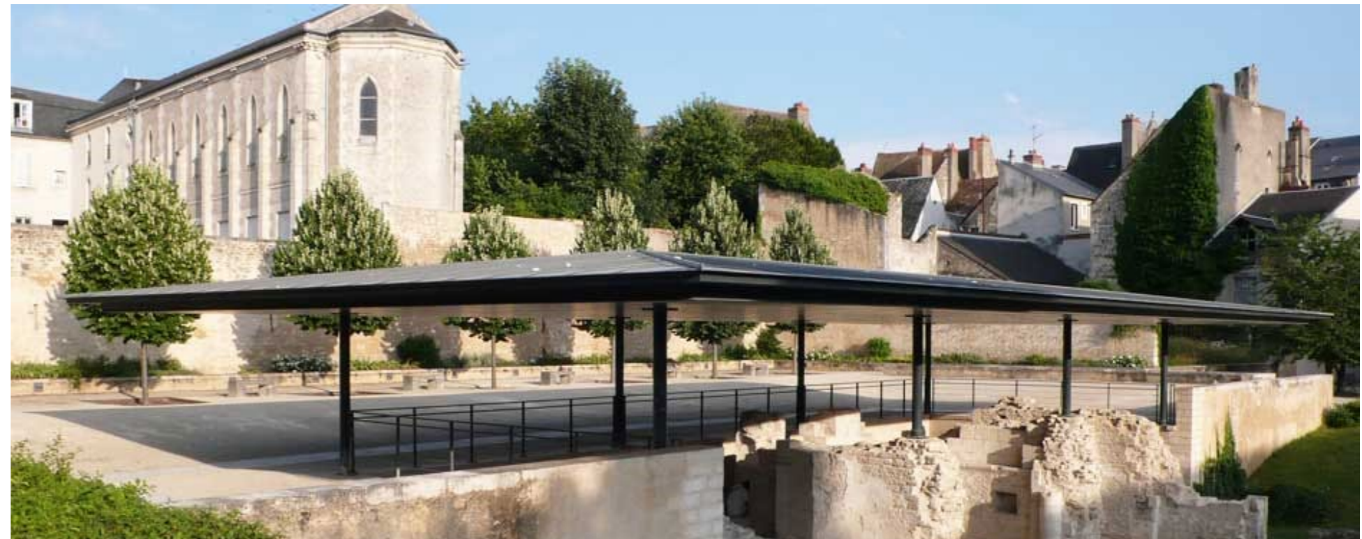
Mise en valeur des vestiges d'une église à La Charité sur Loire // Budget : 573 k€ HT y compris aménagements paysagers
